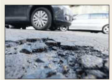
Den miserablen Zustand vieler Landstraßen hatte der Speyerer Rechnungshof bereits vor zwei Jahren beklagt. ARCHIVFOTO: DPA
